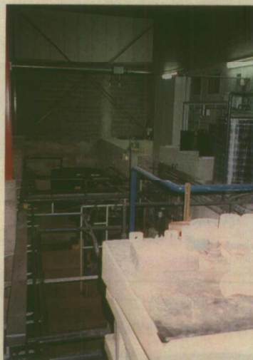
La station d'épuration.
