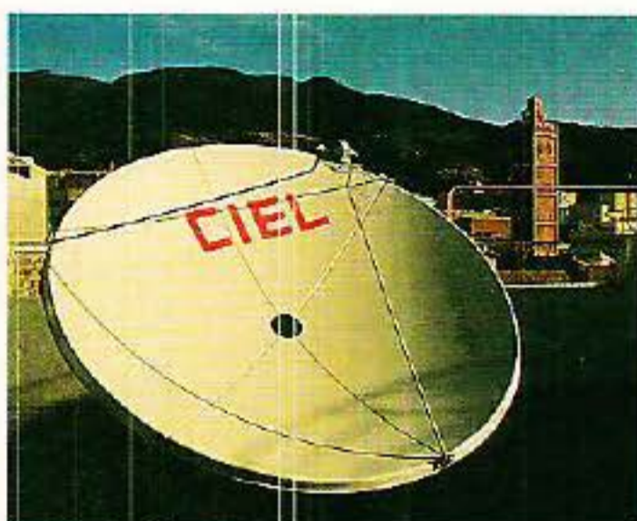
Sur une terrasse, près d'Oujda, une parabole de 1,80 m captant les satellites Eutelsat I et le faisceau est de l'Intelsat VF 11.
