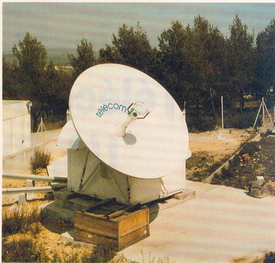
CPTP (Centre Régional Promotionnel Télécommunications Professionnelles) Antenne satellite TELECOM 1 (Ministère des P.etT.)
