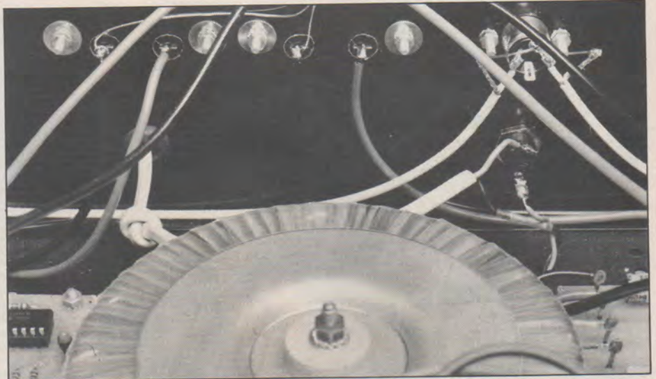
Câblage de la face arrière du TURBO.
